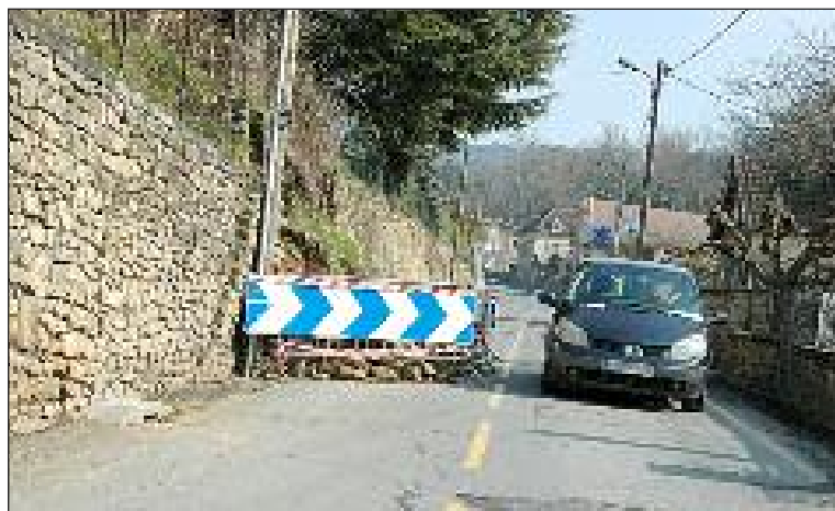
La circulation se fait sur une seule voie au niveau de l'effondrement (Photo GB)
